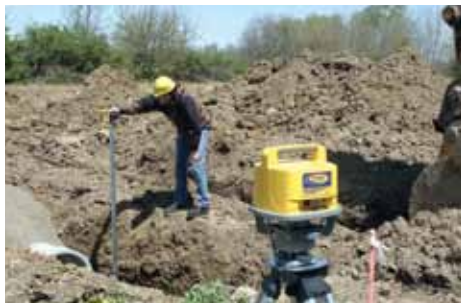
Keine gefährlichen Höhenmessungen an Aushubkanten und in Aushubgräben
